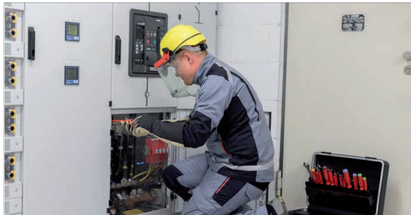
Bild 4. Elektrofachkraft bei der Arbeit an einer Niederspannungsschaltanlage
