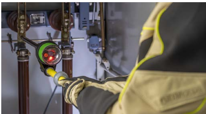
Einpölicher Phasenvergleichler PHV I an einer Schaltanlage.
