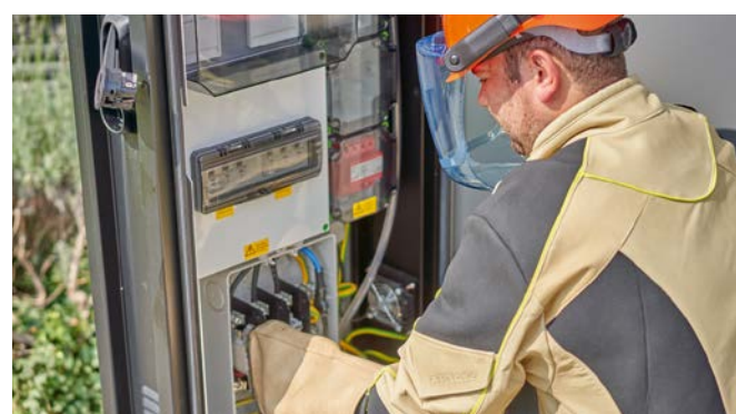
Wartung von Ladesäulen.
