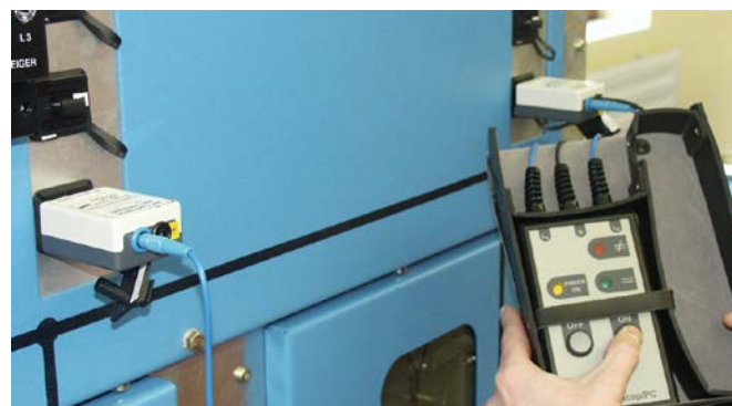
Einsatz des Phasenvergleichers DEHNcap/PC-LRM mit zwei HR-LRM-Messadaptern an einer HR-Schaltanlage.
