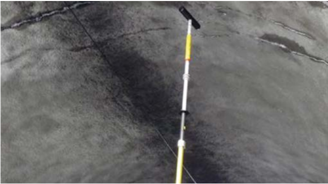
Entfernen von Eiszapfen an Tunnelleinfahrt.
