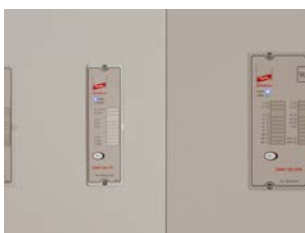
Erfassungsgeräte in der Tür
