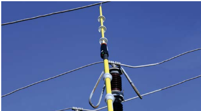
Spannungsprüfer PHE III an einer Freiluftstation 110 kV.
