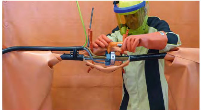
Abdecken von unter Spannung stehenden Teilen.
