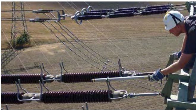
Hochspannungsanzeiger an einer 110 kV-Freileitung.
