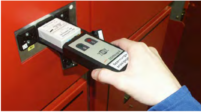
Eigenprüfung des Spannungsanzeigergerätes DEHNcap/A.
