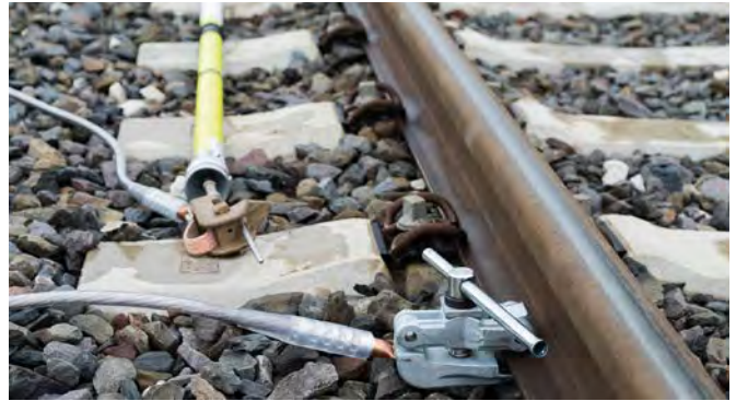
Schienenanschlussklemme am Schienenprofil montiert.
